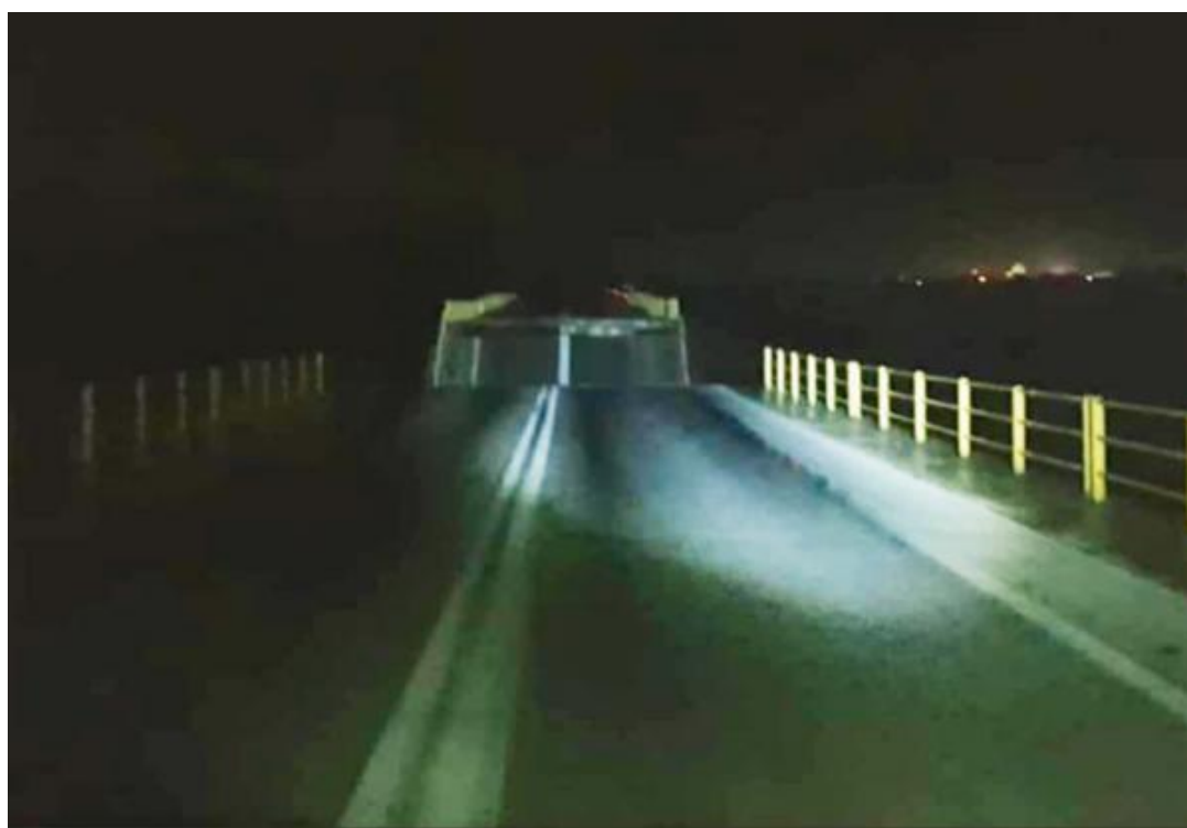
Σχήμα 3.15: Κατάρρευση γέφυρας στο Χαράκι
