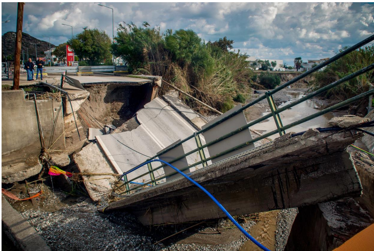
Σχήμα 3.66: Κατεστραμμένη η γέφυρα Ρόδου- Καλλιθέας στο Φαληράκι
