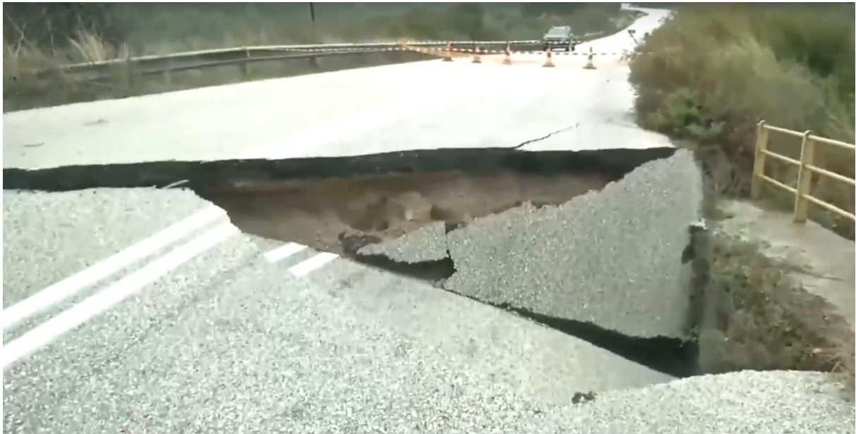
Εικόνα 3-34: Κατέρρευση γέφυρας στην Επ. Οδό στην περιοχή Τορώνης (πηγή: Ναυτεμπορική)
