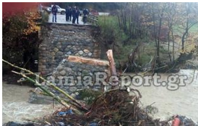
Σχήμα 3.1: Κατεστραμμένη γέφυρα στο Αρτεμίσιο
