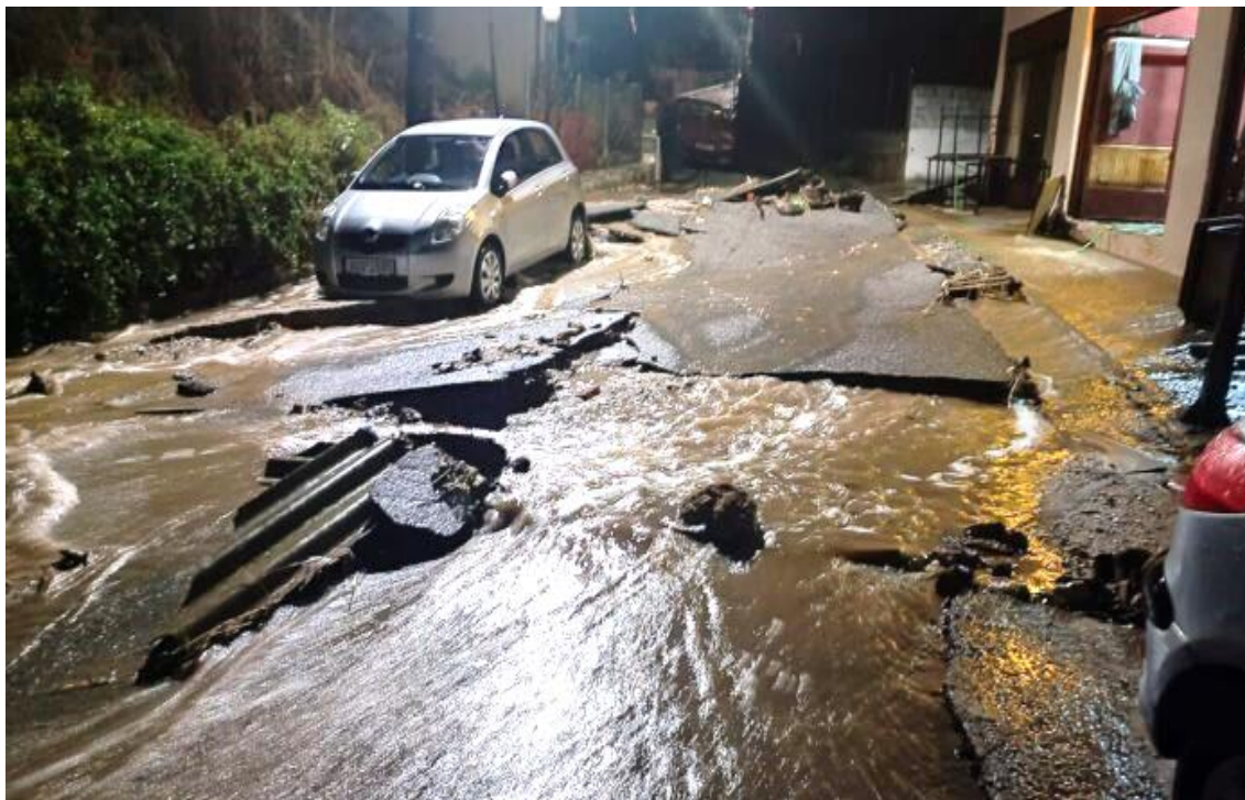
Σχήμα 3.52: Κατεστραμμένος δρόμος στον Πτελεό μετά την πλημμύρα
