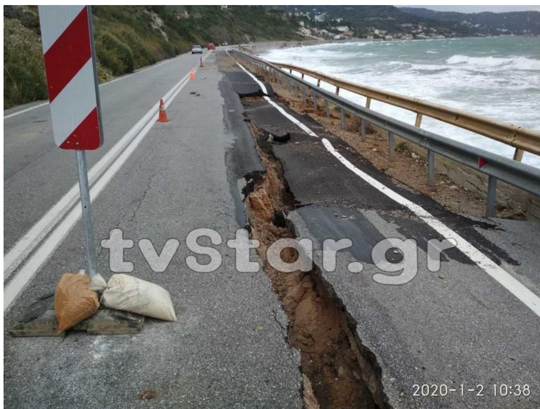
Σχήμα 3.5: Ζημιές στο οδικό δίκτυο στην περιοχή Στόμιο Κύμης Ευβοίας
