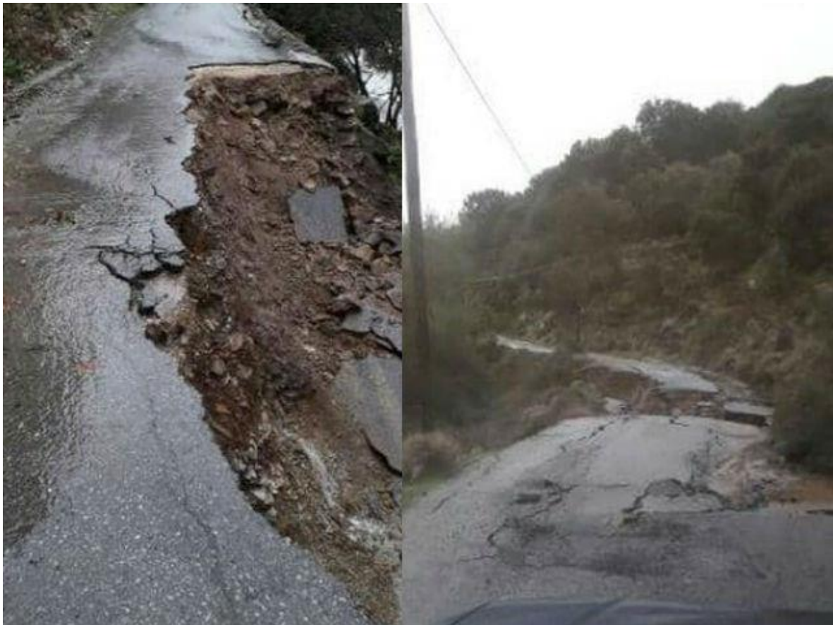
Φωτογραφία 4.1: Επιπτώσεις στο οδικό δίκτυο από την κακοκαιρία Χιόνη (Πηγή: https://flashnews.gr/tag/kakokairia-chania-2/page/13/ )
