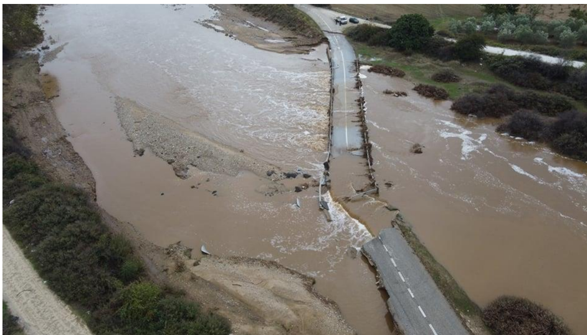
Εικόνα 3.11 Υπερχείλιση γέφυρας . ( https://www.onlarissa.gr/ )
