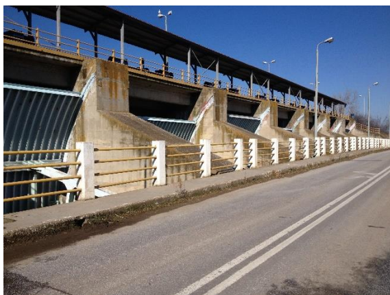
Σχήμα 1-5: Θυροφράγματα στο Φράγμα Λιθότοπου-Κερκίνης.
