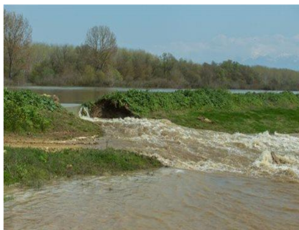
Σχήμα 4-8: Σπασμένο ανάχωμα στην περιοχή του Πεθελινού 29/03/2015.
