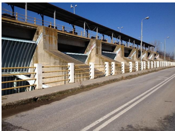
Σχήμα 4-5: Θυροφράγματα στο Φράγμα Λιθότοπου-Κερκίνης.
