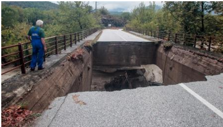
Εικόνα 4-5 Κατάρρευση γέφυρας στον νομό Καρδίτσας (πηγή: https://www.protothema.gr/ )
