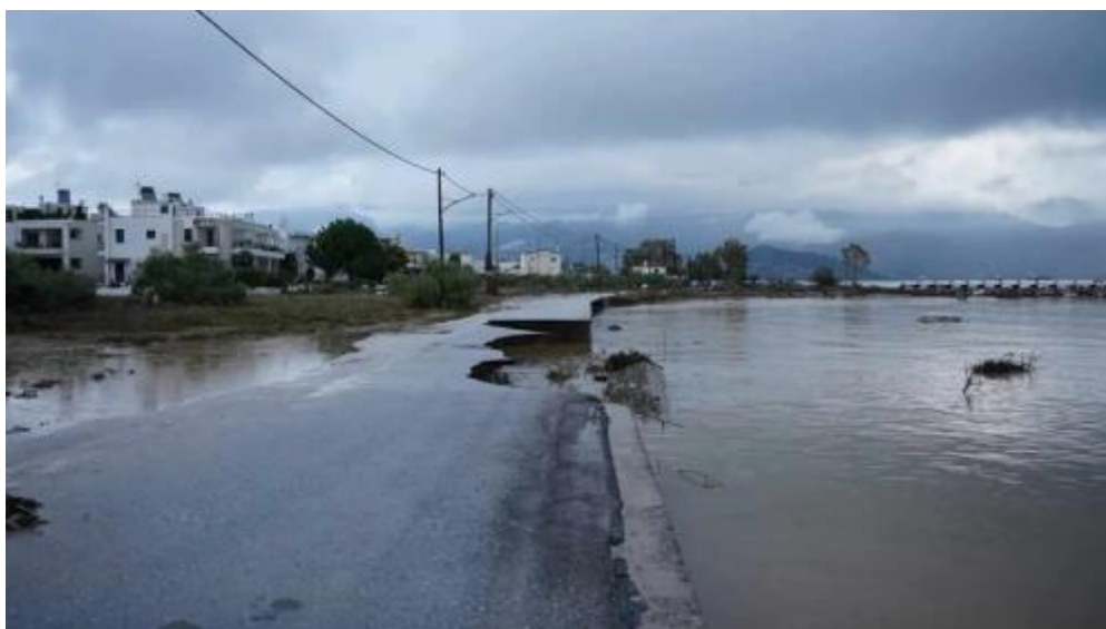
Εικόνα 3-25 Κατάρρευση δρόμου στις Αλυκές Βόλου (πηγή: CNN Greece)
