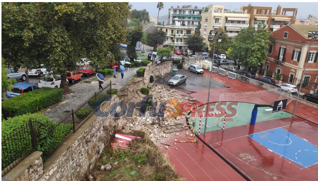
Εικόνα 3-27 Κατάρρευση τοιχίου στο ανοιχτό Γυμναστήριο του Κερκυραϊκού
