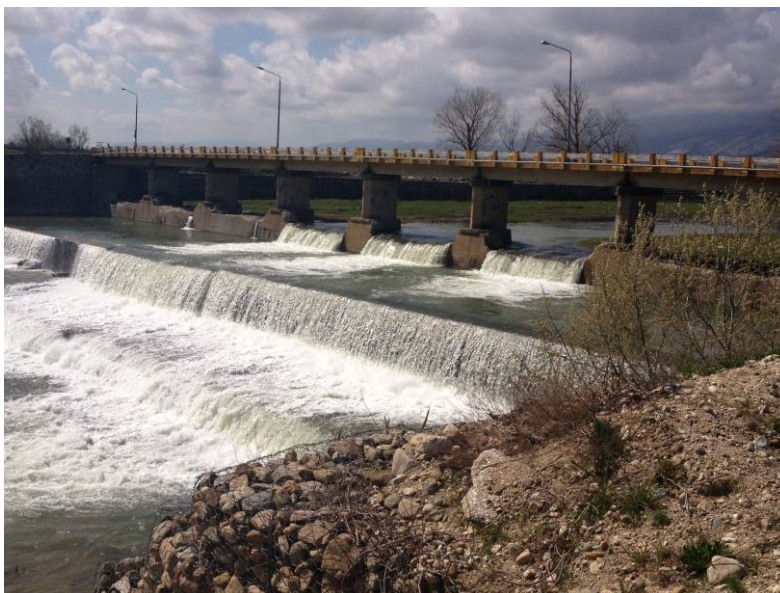
Εικόνα 3.19: Ποταμός Κόσυνθος, (βόρεια του οικισμού Βαφέικα) στο σημείο που επήλθε καταστροφή στην παλαιά ΕΟ Καβάλας-Ξάνθης κατά το πλημμυρικό συμβάν της Γενισέας στις 29-30/11/1996.
