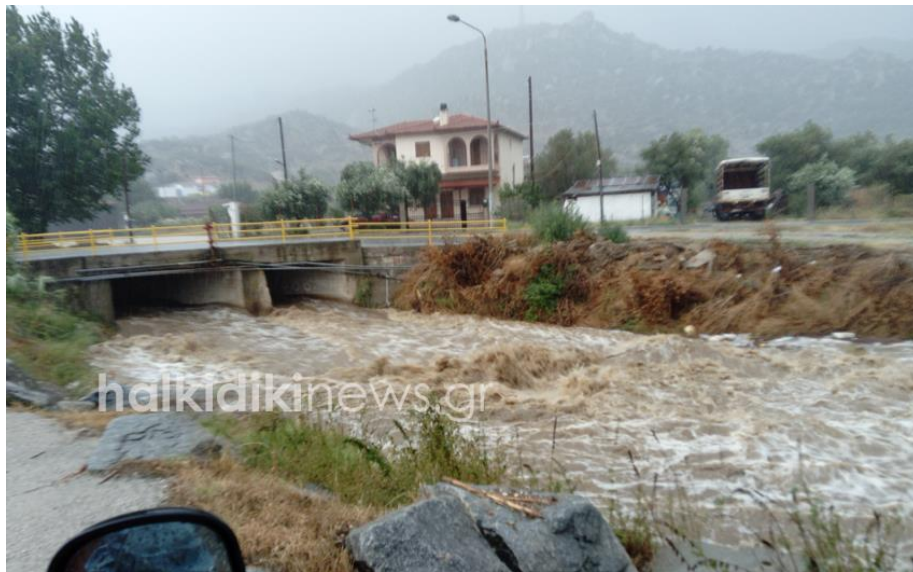
Εικόνα 3-45. Ρέμα Συκιάς, πλημμύρα 17/07/2017
