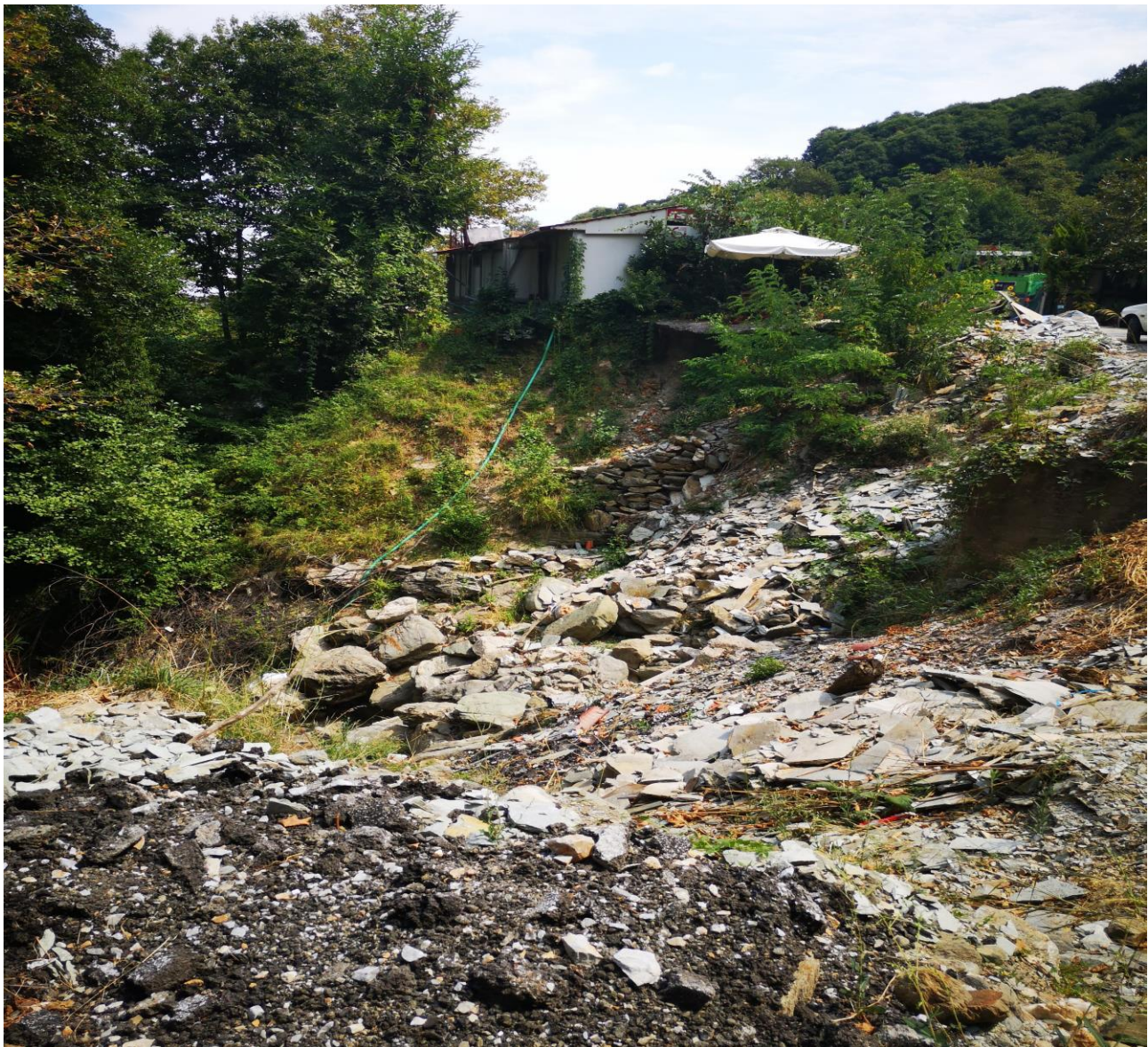
Φ 3-15 Η κοίτη του χειμάρρου κατάντη του κατασκευαζόμενου τεχνικού διάβασης. Παρατηρείται ισχυρότατη διάβρωση που θέτει σε κίνδυνο την εγκατάσταση οικοδομικών υλικών. Η διάβρωση έχει δημιουργηθεί από την υπερχειλίση πλημμυρικής ροής λόγω του ανεπαρκούς παλαιού τεχνικού.
