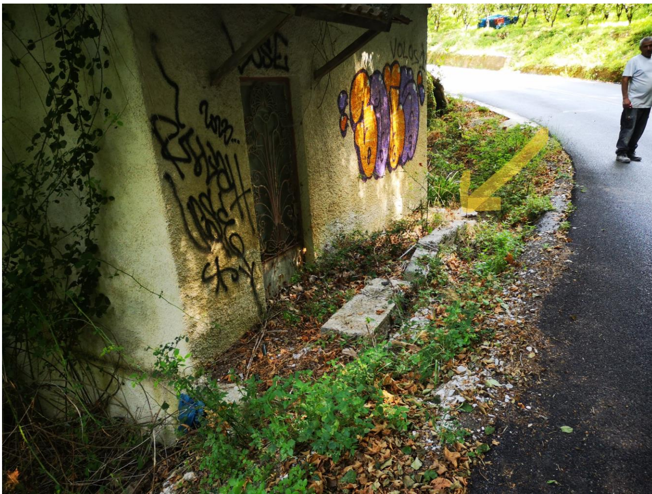
Φ 3-12 Ζαγορά οδός προς Πουρί, πριν από «Οικοδομικά Υλικά Βασιλείου». Καθίζηση – κατολίσθηση στο πρανές όπου η κατοικία.
