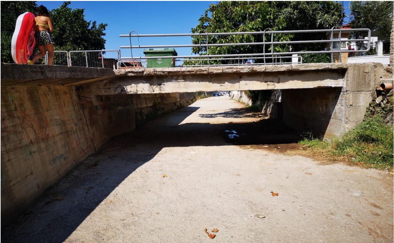
Φ 3-1 Ρουπακιάς. Το τεχνικό από ανάντη. Σημειώνεται συσσώρευση φερτών αριστερά. Κεντρικό βάθρο και σωλήνας μειώνουν την ωφέλιμη διατομή.
