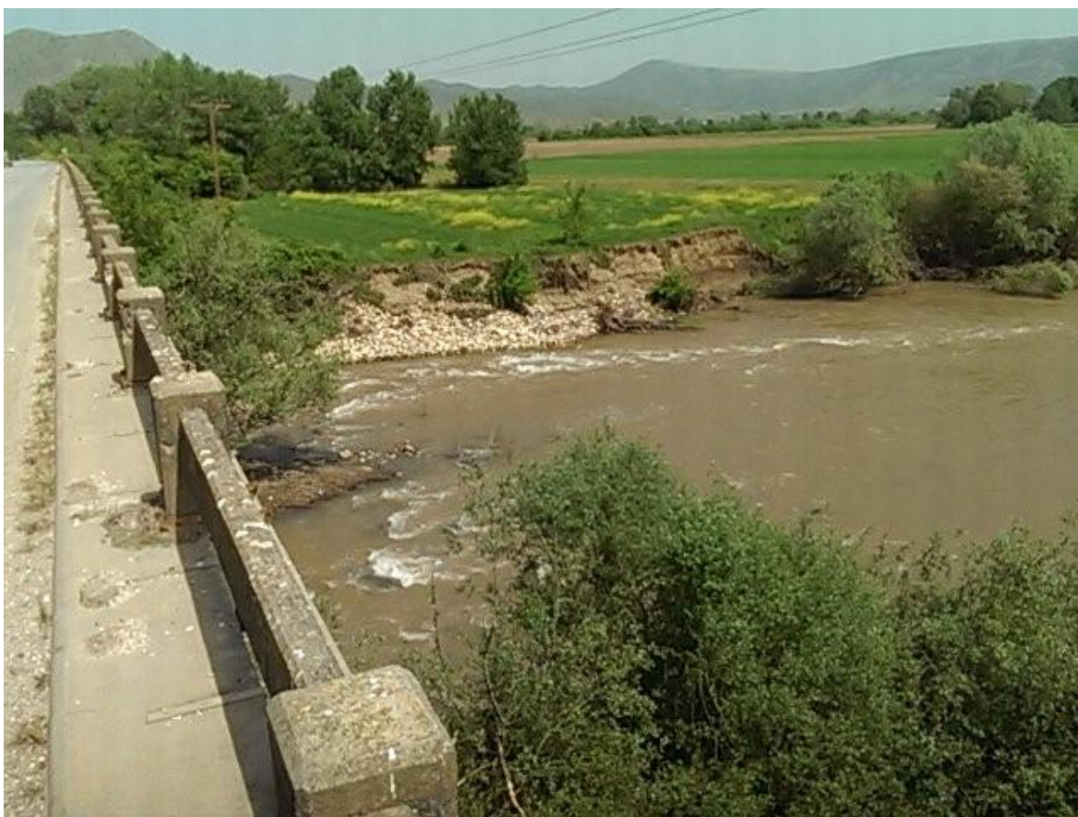
Φωτ. 2: Π. ΠΗΝΕΙΟΣ, ΚΑΤΑΝΤΗ ΣΥΜΒΟΛΗΣ ΝΕΟΧΩΡΙΤΗ. ΓΕΦΥΡΑ ΣΤΗΝ ΟΔΟ ΦΑΡΚΑΔΟΝΑ – ΚΕΡΑΜΙΔΙ. ΣΤΗΝ ΠΕΡΙΟΧΗ ΕΧΟΥΝ ΣΗΜΕΙΩΘΕΙ ΣΗΜΑΝΤΙΚΕΣ ΠΛΗΜΜΥΡΕΣ
