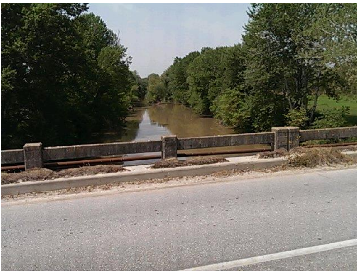
Φωτ. 3: Π. ΠΗΝΕΙΟΣ, ΚΑΤΑΝΤΗ ΣΥΜΒΟΛΗΣ ΝΕΟΧΩΡΙΤΗ. ΓΕΦΥΡΑ ΣΤΗΝ ΟΔΟ ΦΑΡΚΑΔΟΝΑ – ΚΕΡΑΜΙΔΙ. ΣΤΗΝ ΠΕΡΙΟΧΗ ΕΧΟΥΝ ΣΗΜΕΙΩΘΕΙ ΣΗΜΑΝΤΙΚΕΣ ΠΛΗΜΜΥΡΕΣ
