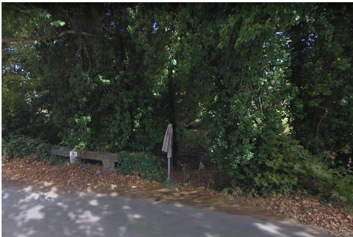
Σχήμα 3.8: Οχετός προς τα ανάντη της κοίτης του ρέματος
