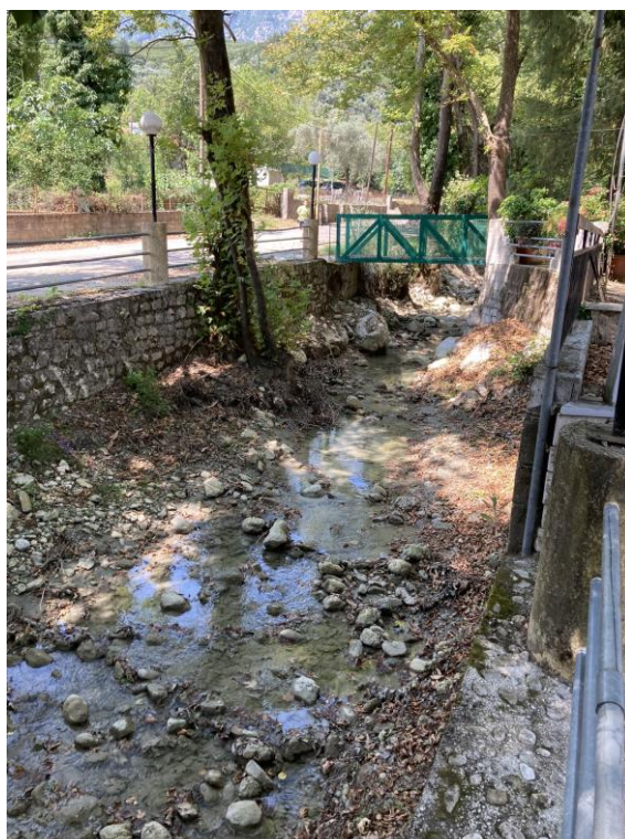
Φ 3-1 Ρέμα που διέρχεται από τον Οικισμό Χρυσαιγής. Πιθανώς ανεπαρκές τεχνικό – ελεύθερο ύψος τεχνικού δεσμεύεται από οδοποιία.
