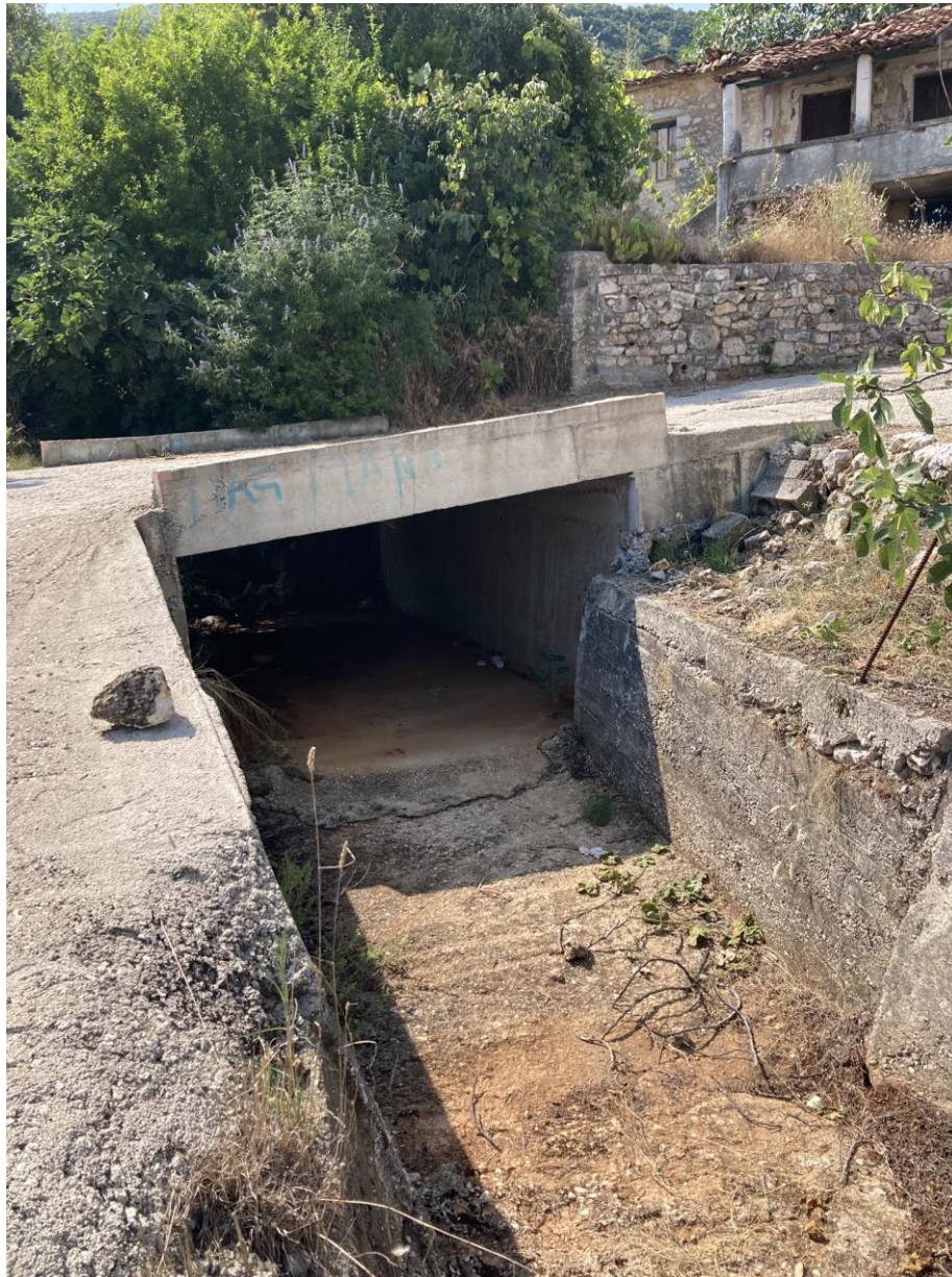
Φ 3-12 Τεχνικό ρέματος στον οικισμό της Γκρίκας – κατάντη άποψη. Δεξιά διακρίνονται κατοικίες. Ανάντη του τεχνικού διακρίνεται πολύ πυκνή βλάστηση που περιορίζει σημαντικά τη διατομή.
