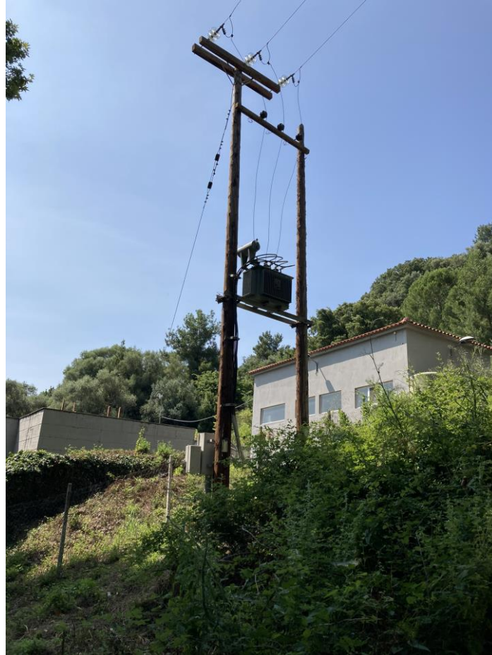
Φ 3-9 Δεξαμενή και οικίσκος αντλιοστασίου πλησίον ρέματος που διέρχεται από τον οικισμό Κρυσταλλοπηγής
