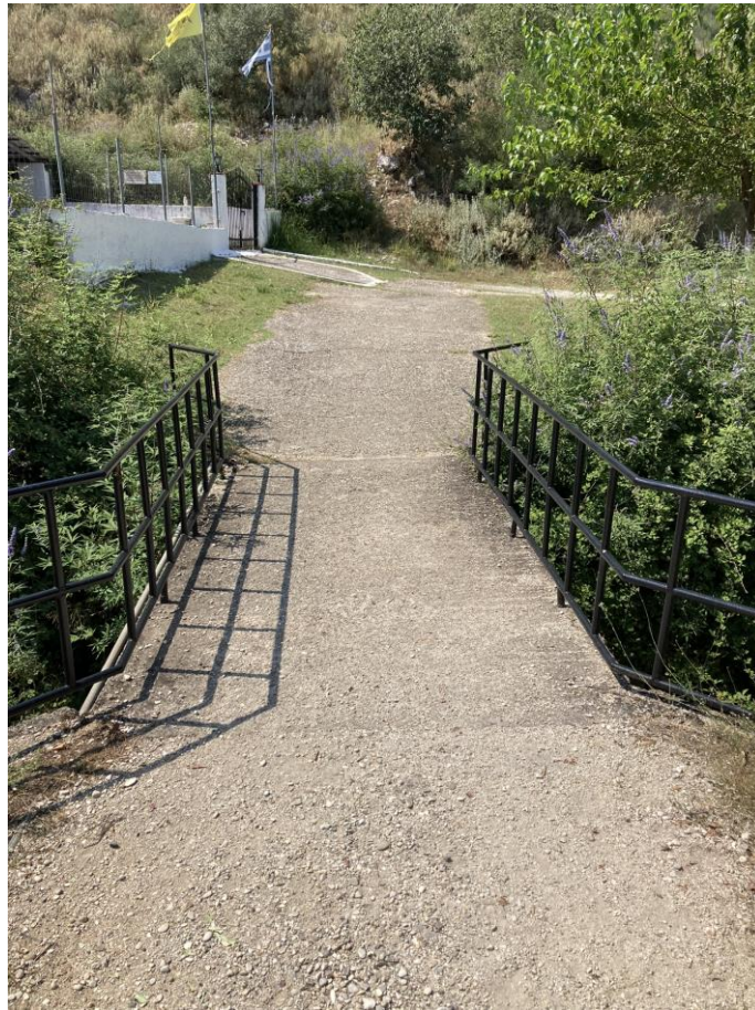
Φ 3-8 Τεχνικό στο ρέμα Οικισμού Παγκρατίου ( Παγκράτες ). Παρατηρείται πολύ πυκνή βλάστηση ανάτη και κατάντη του τεχνικού.
