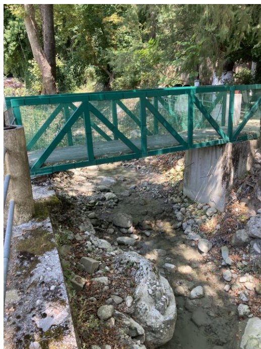
Φ 3-5 Τεχνικό στο ρέμα που διέρχεται από τον Οικισμό της Χρυσσαυγής το οποίο προκαλεί στένωση της διατομής του ποταμού και πιθανώς στραγγαλισμό της πλημμυρικής ροής του ρέματος.
