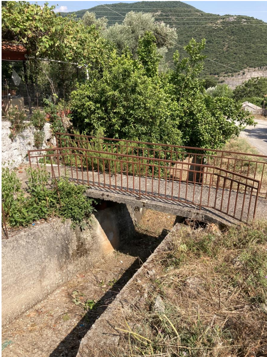
Φ 3-13 Ανεπαρκές τεχνικό ρέματος στον οικισμό της Γκρίκας – κατάντη άποψη. Αριστερά διακρίνεται αυλή κατοικίας. Το τεχνικό υπερχειλίζει σε γεγονότα βροχοπτώσεων και κατακλύζει το δρόμο και τις αυλές των κατοικιών.
