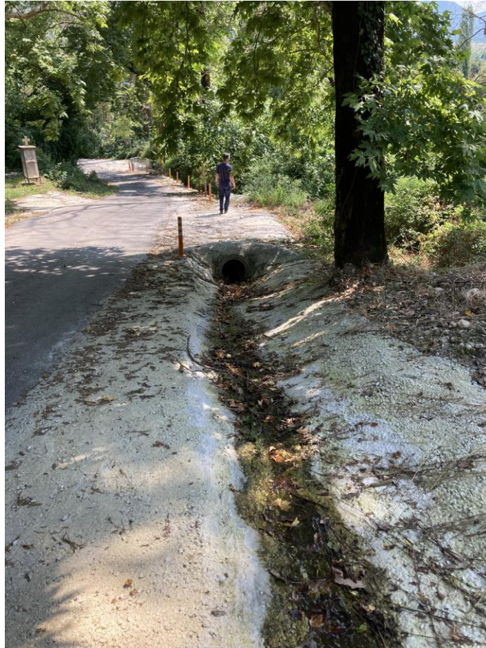
Φ 3-10 Κυκλικός οχετός πλησίον ρεμάτιου που διέρχεται από τον οικισμό Κρυσταλλοπηγής. Ανεπαρκής διατομή.
