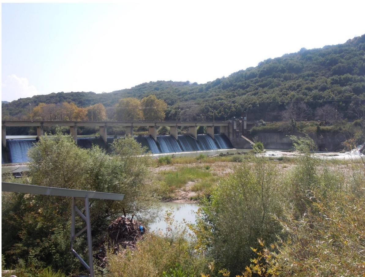
Φωτ. 3: ΤΟ ΑΡΔΕΥΤΙΚΟ ΦΡΑΓΜΑ ΡΑΓΙΟΥ ΣΤΟΝ ΠΟΤΑΜΟ ΚΑΛΑΜΑ. ΣΗΜΕΙΩΝΟΝΤΑΙ ΠΛΗΜΜΥΡΙΚΑ ΦΑΙΝΟΜΕΝΑ ΑΝΑΝΤΗ, ΙΔΙΑΙΤΕΡΑ ΣΤΗΝ ΠΕΡΙΟΧΗ ΒΡΥΣΕΛΛΑΣ.
