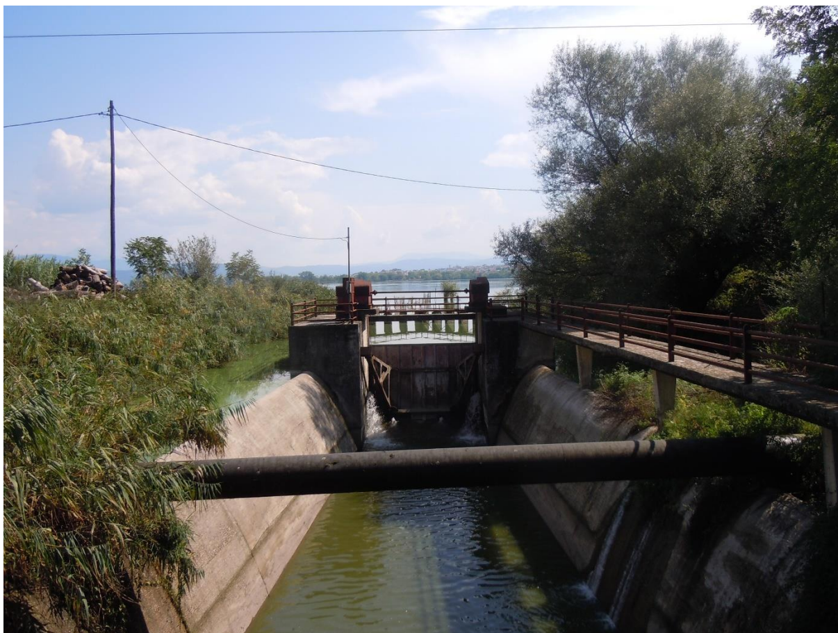
Φωτ. 1: ΛΙΜΝΗ ΙΩΑΝΝΙΝΩΝ: ΤΟ ΘΥΡΟΦΡΑΓΜΑ ΕΛΕΓΧΟΥ ΣΤΟ ΠΕΡΑΜΑ
