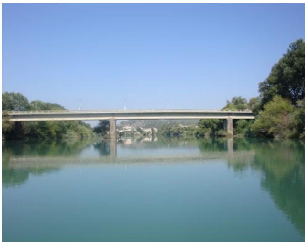
Εικόνα 6-51 Όψεις γέφυρας Μάστρο – Κατοχή από κατάντη (πηγή: «Έρευνα Κατάκλυσης Κοίτης Ποταμού Αχελώου Κατάντη του Φράγματος του Στράτου», ΕΜΠ, 2010)
