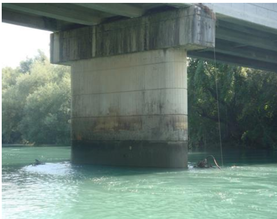
Εικόνα 6-49 Όψεις γέφυρας Γουριάς – Πεντάλοφου από ανάντη (άνω) και από τα κατόντη (κάτω) (πηγή: «Έρευνα Κατάκλυσης Κοίτης Ποταμού Αχελώου Κατόντη του Φράγματος του Στράτου», ΕΜΠ, 2010)
