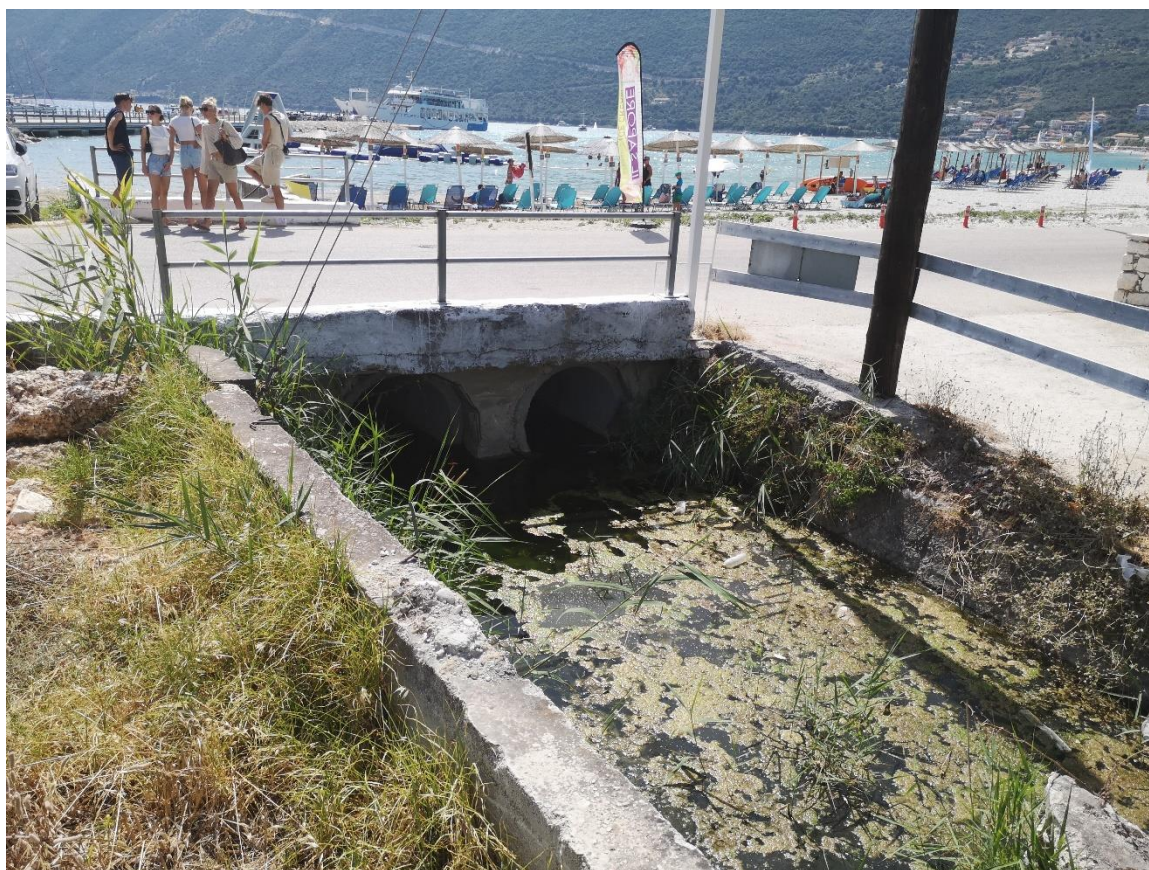
Φ 3-34 Υφιστάμενοι σωληνωτοί οχετοί, λειτουργούν ανασχετικά σε ισχυρές βροχοπτώσεις.
