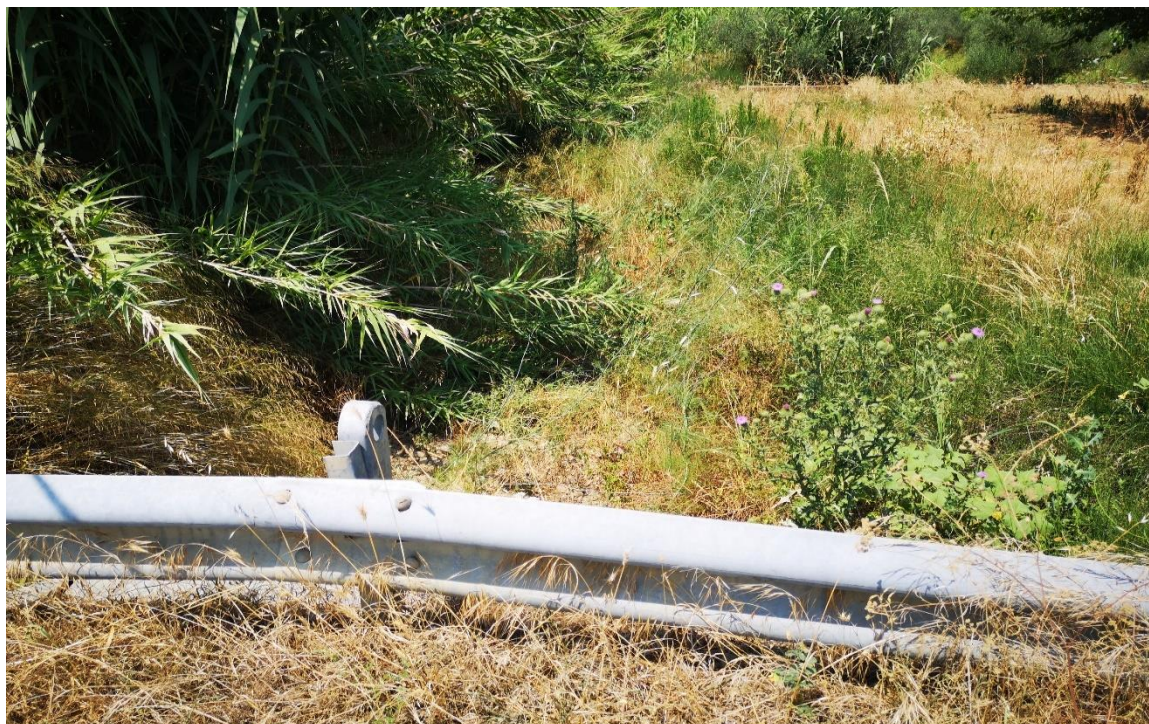
Φ 3-20 Ζευγαράκι Γ. Προς κατόντη. Ανεπαρκής διατομή ρέματος.
