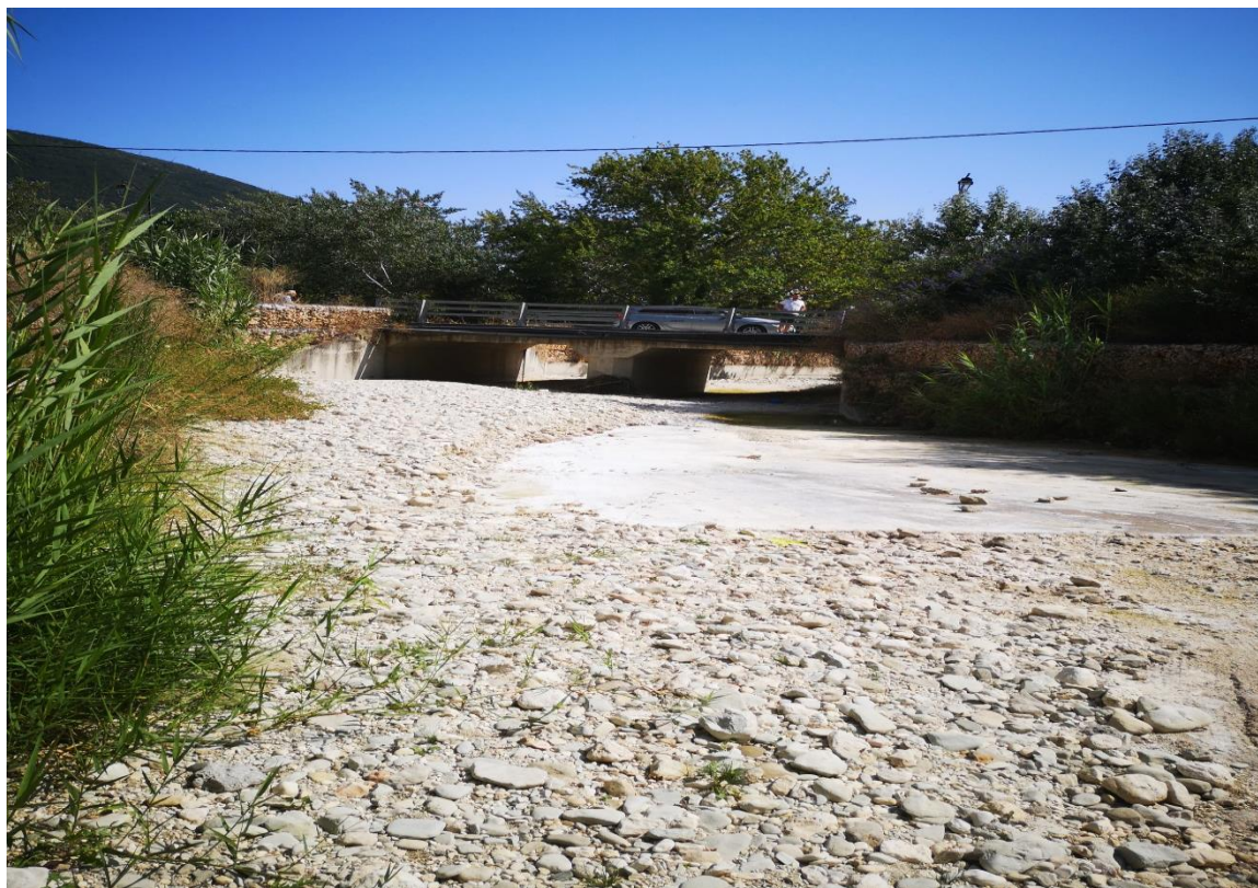
Φ 3-39 Ρουπακιάς. Το τεχνικό από ανάντη. Σημειώνεται συσσώρευση φερτών αριστερά. Κεντρικό βάθρο και σωλήνας μειώνουν την ωφέλιμη διατομή.
