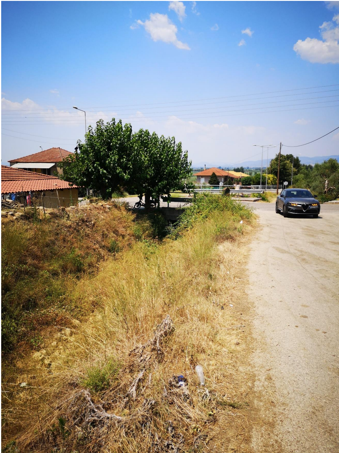
Φ 3-15 Ζευγαράκι Α. Επιχωμένη διατομή με φερτά. Ανεπαρκής διατομή ανάντη σε συνδυασμό με τεχνικό.
