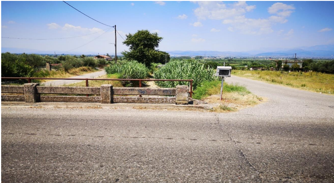
Φ 3-16 Ζευγαράκι Β. Επαρχιακή Οδός Ζευγαράκι – Κάτω Μακρινού. Ανεπαρκής διατομή ρέματος. Άποψη προς κατάντη.
