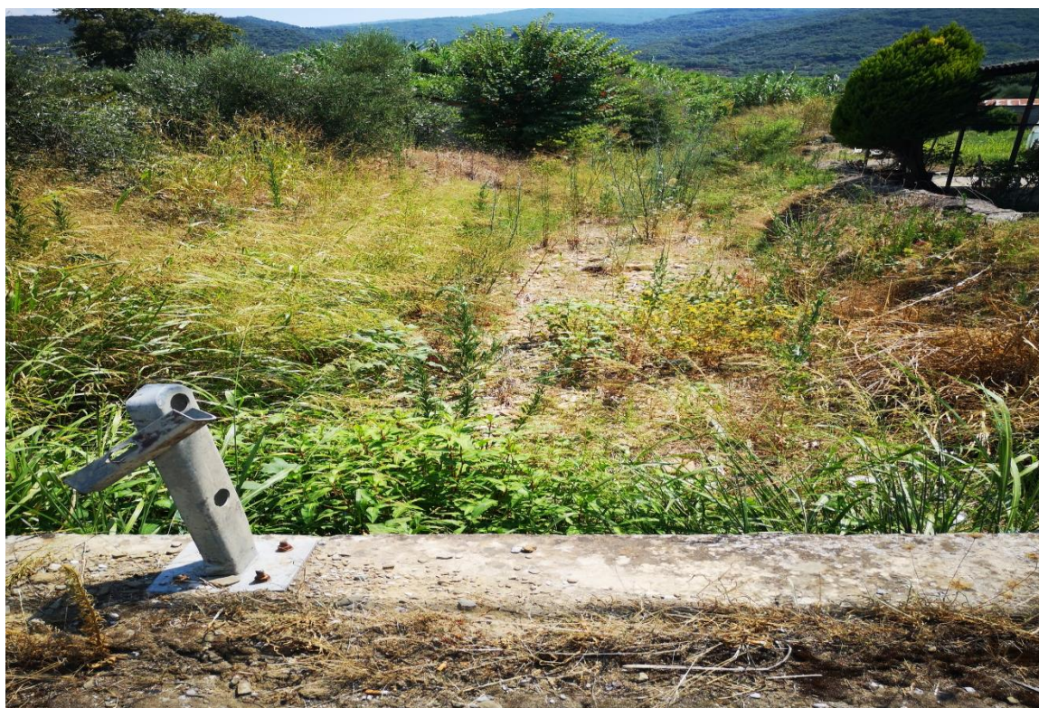
Φ 3-21 Ζευγαράκι 3. Προς ανάντη. Ανεπαρκής διατομή. Κατοικία στο πεδίο πλημμύρας.
