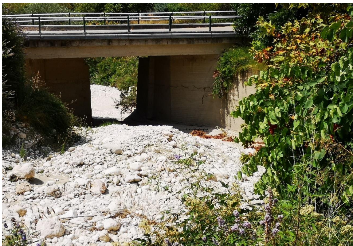
Φ 3-25 Βάρνακας. Άποψη τεχνικού από ανάντη προς κατάντη. 04/01/2021. Παρουσιάζεται ισχυρή στένωση και σοβαρή συσσώρευση φερτών.
