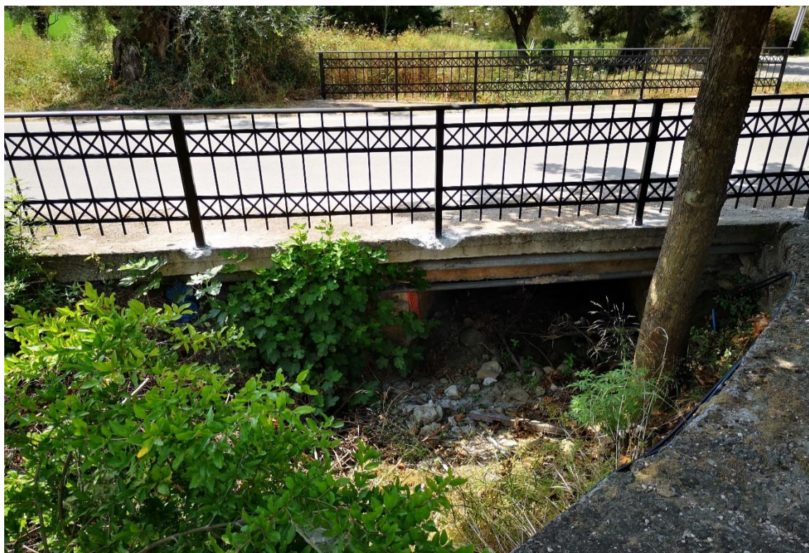
Φ 3-27 Τεχνικό στο ρέμα περιοχής Κανδήλας ανάντη. Ανεπαρκές τεχνικό, επιχωμένο.
