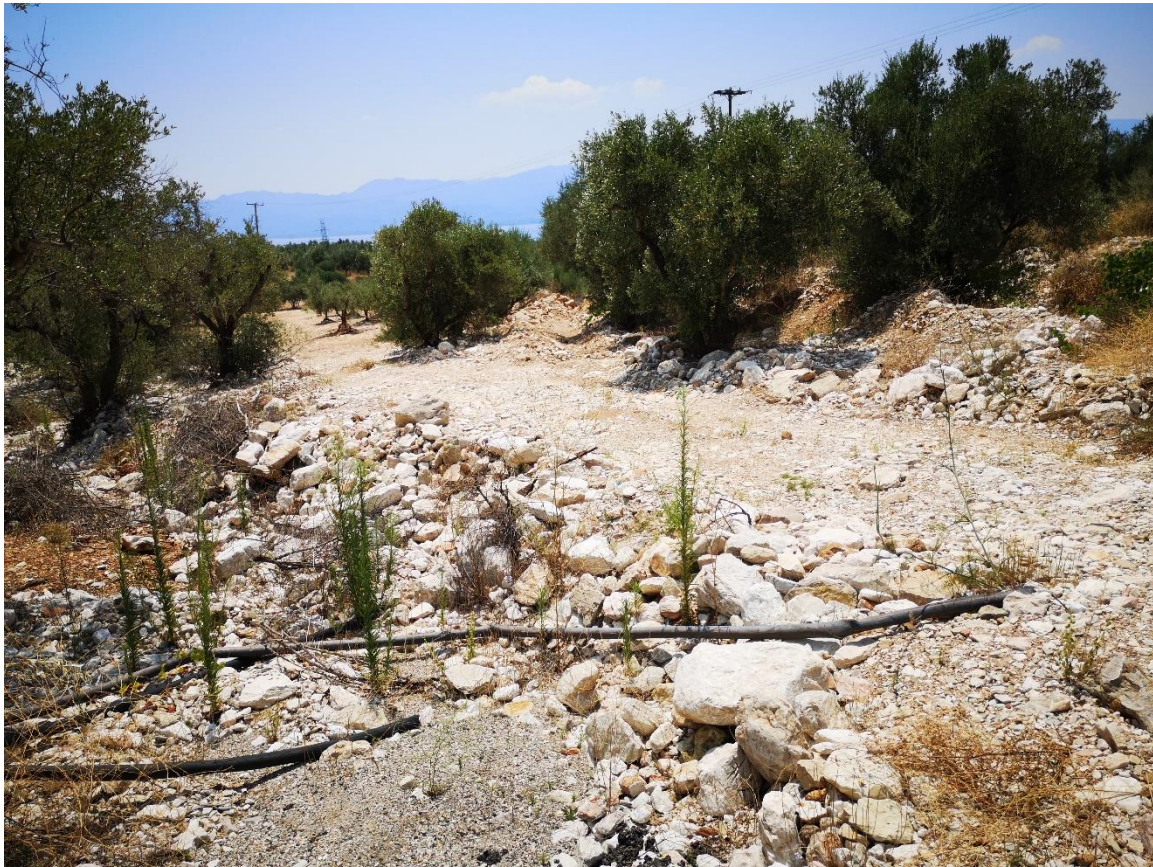
Φ 3-5 Επαρχιακή Οδός Παραβόλας – Θέρμου. Ρέμα ανατολικά Παραβόλας. Άποψη κατάντη. Μεγάλη ποσότητα φερτών.
