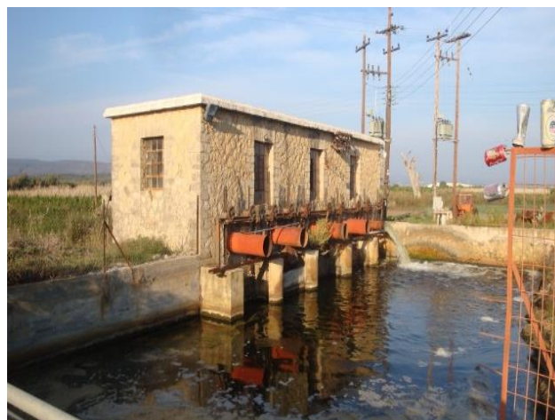
Φωτογραφία 9.5: Αντλιοστάσιο Τρινάσου
