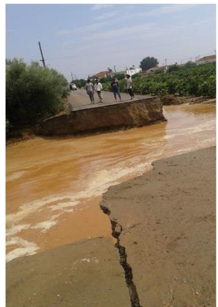
Φωτογραφία 9.3: Κατέρρευση τμήματος δρόμου προς Λεήμονα (Πηγή:
