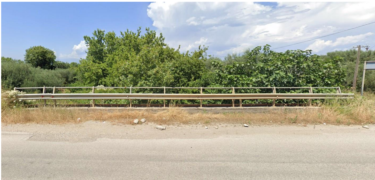
Φωτογραφία 3.11: Κατάντη όψη γέφυρας, επί της παλαιάς Ε.Ο. Κορίνθου-Πατρών, με έντονη βλάστηση (ΕΛ02_PH_09)
