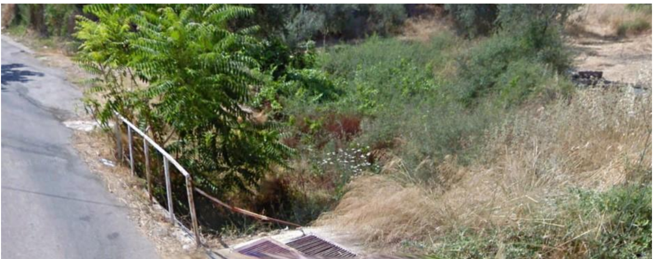
Φωτογραφία 3.3: Ανάντη όψη τεχνικού διέλευσης ρέματος που χρήζει καθαριότητας λόγω έντονης βλάστησης (EL02_PH_02)
