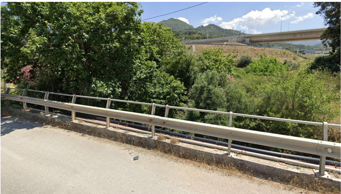
Φωτογραφία 3.10: Ανάντη όψη γέφυρας, επί της παλαιάς Ε.Ο. Κορίνθου-Πατρών, με έντονη βλάστηση (EL02_PH_08)
