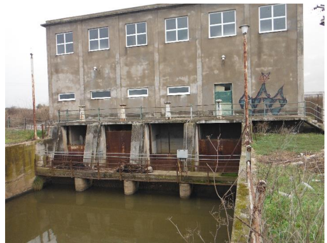
Φωτογραφία 9.15: Αντλιοστάσιο Σπιάτζας.
