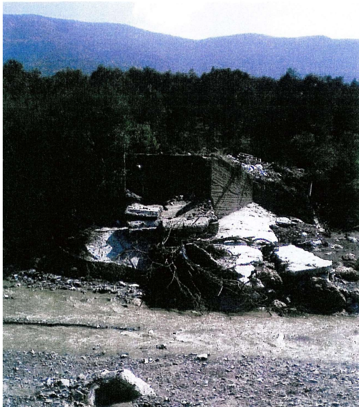
Σχήμα 7.14: Σαρανταπόταμος - Θέση Αχλαδίτσα, Άνω Καλλιθέας. Πλήρης καταστροφή γέφυρας. Απαιτείται καθαίρεση και επανακατασκευή.
