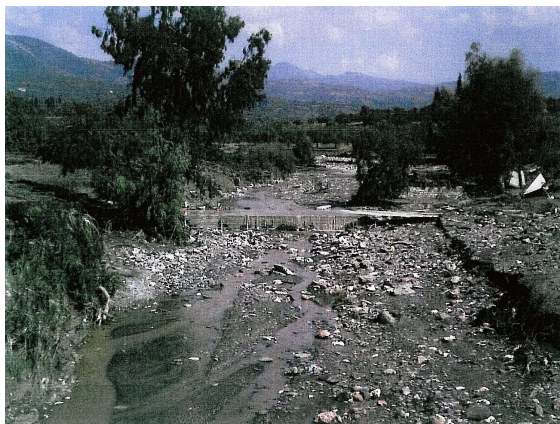
Σχήμα 7.12: Θέση γέφυρα Καλλιθέας. Επιχωμάτωση γέφυρας με σωληνωτούς οχετούς. Απαιτείται καθαρισμός και διευθέτηση της όχθης με συρματοκιβώτια.
