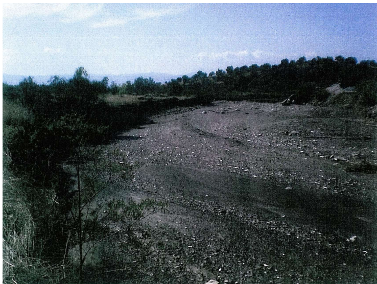
Σχήμα 7.15: Σαρανταπόταμος - Θέση πλησίον μετόν Συρμακέζη (Άνω Βάθεια) Καταστροφή ιρλανδικής διάβασης και όχθης ποταμού. Απαιτούνται εργασίες διαμόρφωσης της κοίτης και διευθέτησης της όχθης με φυσικούς ογκόλιθους Πτώση τμήματος πέτρινου τοίχου.
