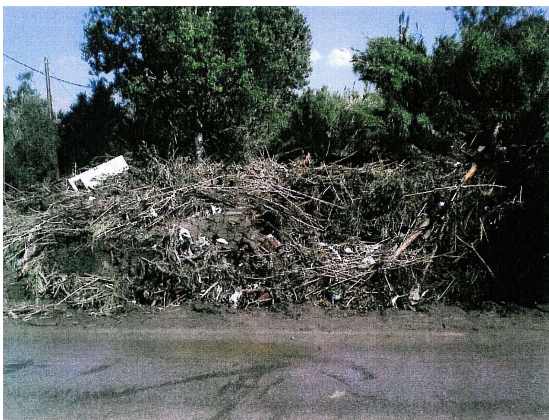
Σχήμα 7.11: Σαρανταπόταμος – Τμήμα ανάντη της γέφυρας Εθνικής οδού. Απαιτείται άμεσος καθαρισμός.
