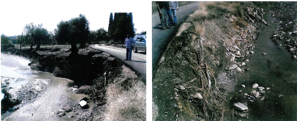
Σχήμα 7.16: Σαρανταπόταμος – Θέση Άνω Καλλιθέα πρηνών ποταμού – άκρης δημοτικής οδού. Απαιτείται καθαρισμός και διευθέτηση της όχθης με συρματοκιβώτια.
