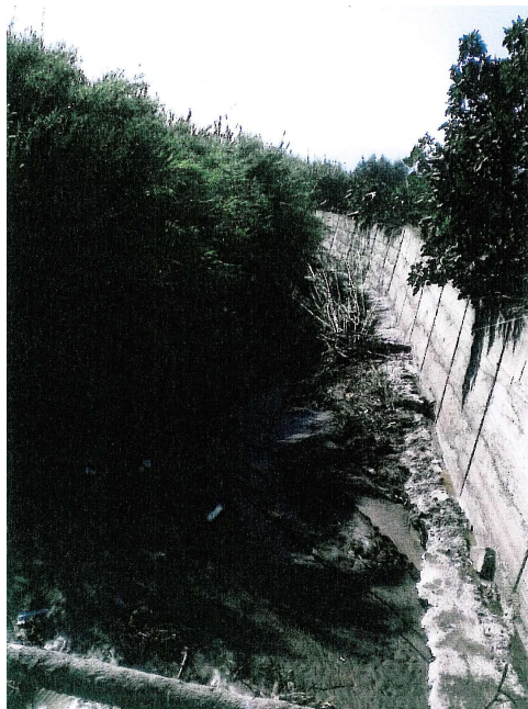
Σχήμα 7.13: Σαρανταπόταμος – Τμήμα κατάντη της γέφυρας Εθνικής οδού. Υπάρχει εκσκαφής των θεμελίων τοιχίου μήκους 100μ. περίπου.
