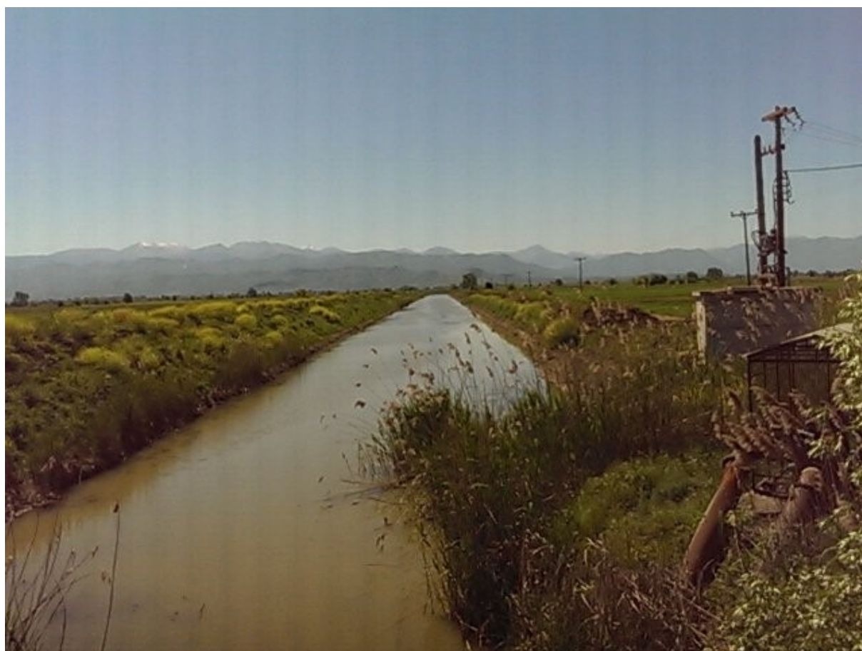
Φωτ. 9: Ο Π. ΜΕΓΑΣ ΑΠΟ ΓΕΦΥΡΑ ΣΤΗΝ ΟΔΟ ΑΓ.ΤΡΙΑΔΑ ΚΑΡΔΙΤΣΟΜΑΓΟΥΛΑ. ΔΙΑΚΡΙΝΟΝΤΑΙ ΟΙ ΕΡΓΑΣΙΕΣ ΚΑΘΑΡΙΣΜΟΥ ΤΗΣ ΚΟΙΤΗΣ.
