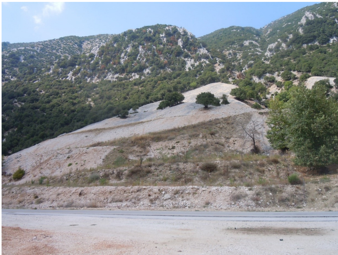
Φωτ. 1: ΡΟΔΑΥΓΗ ΑΡΤΑΣ. ΚΩΝΟΣ ΚΟΡΗΜΑΤΩΝ ΣΤΟ ΠΡΑΝΕΣ ΤΗΣ ΟΔΟΥ ΑΡΤΑΣ – ΡΟΔΑΥΓΗΣ. ΚΑΤΟΛΙΣΘΗΣΕΙΣ ΣΥΜΒΑΙΝΟΥΝ ΣΕ ΠΕΡΙΟΔΟΥΣ ΙΣΧΥΡΩΝ ΒΡΟΧΟΠΤΩΣΕΩΝ.
