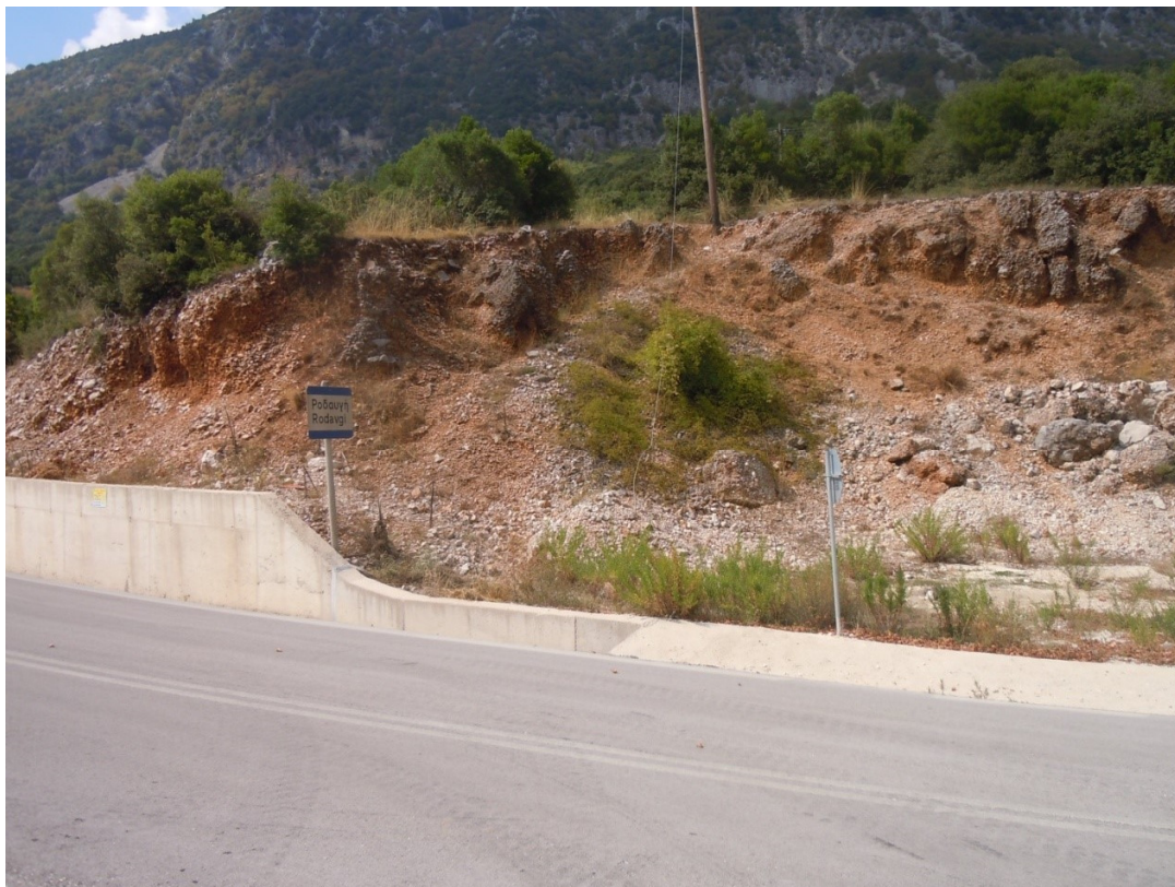
Φωτ. 3: ΡΟΔΑΥΓΗ ΑΡΤΑΣ: ΑΣΤΑΘΗ ΠΡΑΝΗ ΜΕ ΤΟΙΧΟ ΑΝΤΙΣΤΗΡΙΞΗΣ
