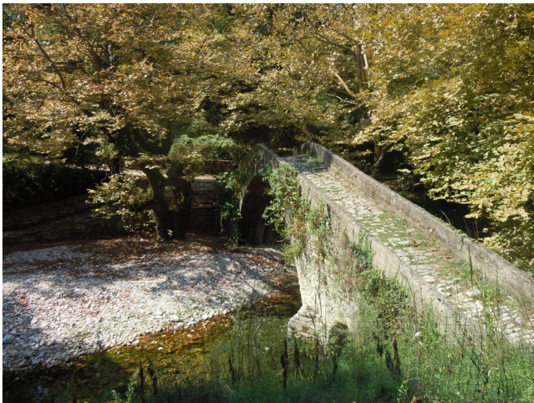
Φωτ. 8: Π. ΖΑΛΟΓΓΙΤΙΚΟΣ. ΓΕΦΥΡΙ ΒΡΟΣΙΝΑΣ. ΣΗΜΕΙΩΝΟΝΤΑΙ ΠΛΗΜΜΥΡΙΚΑ ΦΑΙΝΟΜΕΝΑ ΜΕ ΚΑΤΑΚΛΥΣΗ ΤΗΣ ΕΘΝΙΚΗΣ ΟΔΟΥ ΙΩΑΝΝΙΝΩΝ – ΗΓΟΥΜΕΝΙΤΣΑΣ ΚΑΙ ΤΜΗΜΑΤΟΣ ΤΗΣ ΓΕΦΥΡΑΣ
