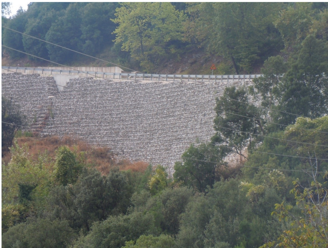
Φωτ. 2: ΡΟΔΑΥΓΗ ΑΡΤΑΣ: ΕΡΓΑ ΑΝΤΙΣΤΗΡΙΞΗΣ ΠΡΑΝΟΥΣ. ΔΙΑΚΡΙΝΕΤΑΙ ΤΟ ΕΡΓΟ ΕΚΒΟΛΗΣ ΟΧΕΤΟΥ ΟΜΒΡΙΩΝ
