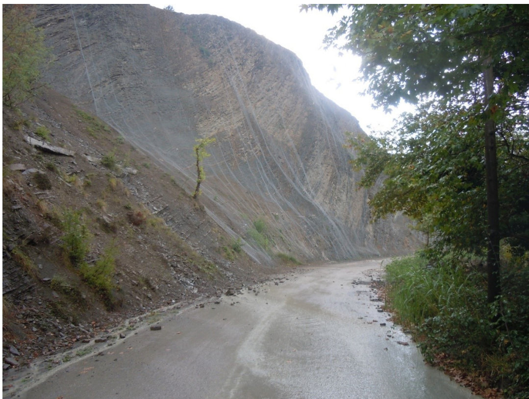
Φωτ. 5: ΟΔΟΣ ΒΑΘΥΚΑΜΠΟΥ – ΦΤΕΡΗΣ. ΔΙΑΚΡΙΝΕΤΑΙ ΚΑΘΙΖΗΣΗ ΤΟΥ ΟΔΟΣΤΡΩΜΑΤΟΣ ΚΑΙ ΕΡΓΑ ΣΥΓΚΡΑΤΗΣΗΣ ΛΙΘΩΝ ΣΤΟ ΑΣΤΑΘΕΣ ΠΡΑΝΕΣ.
