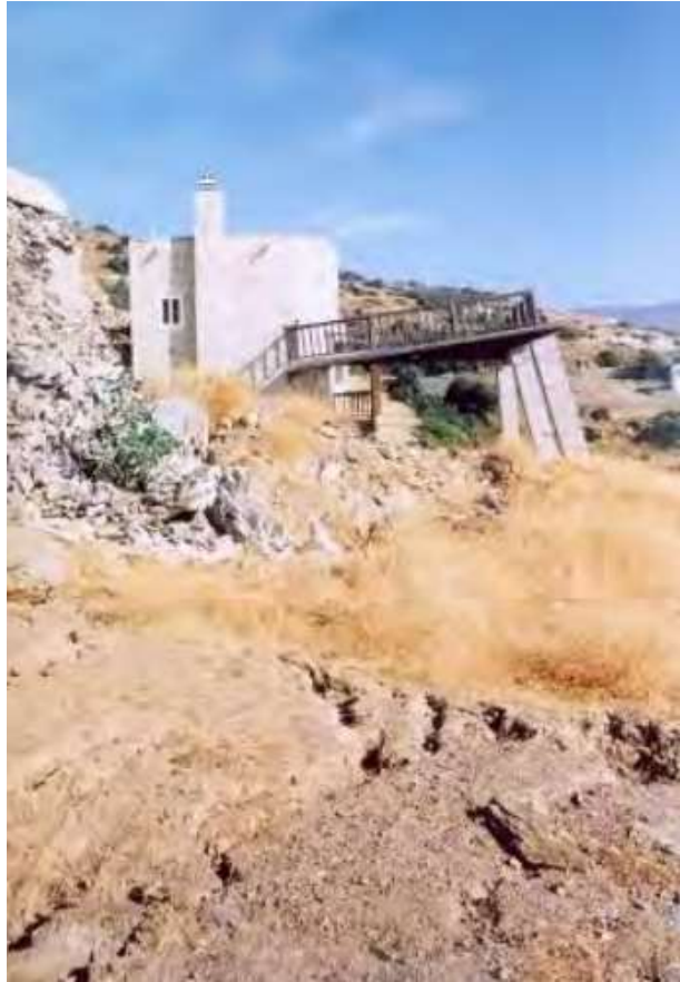
Σχήμα 5.8: Ρωγμές στην περιοχή της αστοχίας
