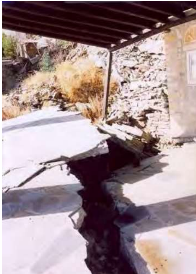
Σχήμα 5.9: Ρωγμή στην κατοικία δίπλα στην επαρχιακή οδό
