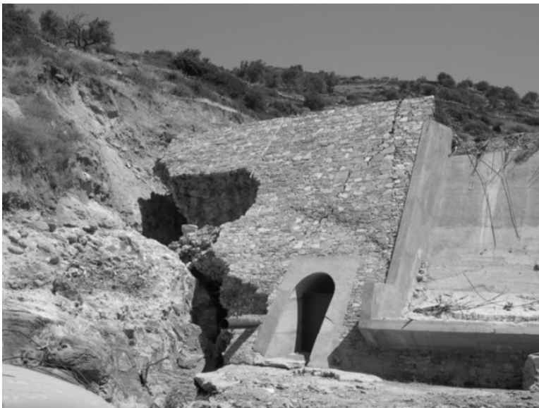
Σχήμα 5.3: Αστοχία στο φράγμα Καμαρών
