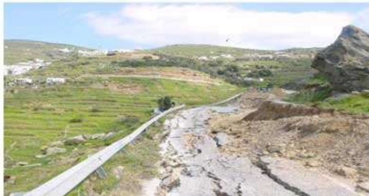
Σχήμα 5.15: Καταστροφές σε δρόμο της Τήνου
