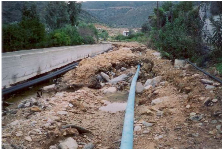
Σχήμα 5.11: Διάβρωση στην οδό που ενώνει το έργο με την οδό της παραλίας του Μυλοποτάμου
