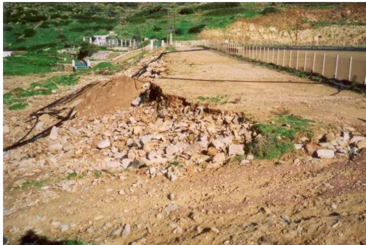
Σχήμα 5.12: Διαβρωμένη στέψη φράγματος
