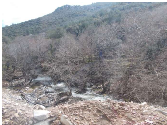
Σχήμα 5.10: Κατά μήκος του δρόμου που οδηγεί από την παραλία (Σκάλα Μαριών) στο χωριό των Μαριών το πρηνές του δρόμου υποχωρεί σε πολλά σημεία από τα τοπικά πλημμυρικά φαινόμενα και τις έντονες καταιγίδες.
