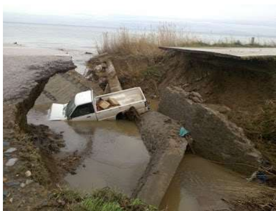
Σχήμα 5.11: Πλημμύρα 15/12/2009. Κατάπτωση γέφυρας το 2ο χλμ. επαρχιακής οδού Καμαριώτισσας – Θέρμων.
