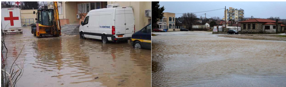
Σχήμα 7.42: Προαύλιος χώρος Νοσοκομείου Κομοτηνής (αριστερά), πλημμυρισμένα σπίτια στον Αγ. Στυλιανό Κομοτηνής (δεξιά).
