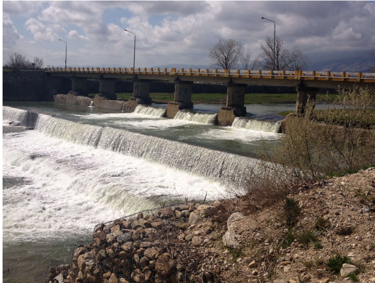
Σχήμα 7.43: Ποταμός Κόσυνθος, (βόρεια του οικισμού Βαφέικα) στο σημείο που επήλθε καταστροφή στην παλαιά ΕΟ Καβάλας-Ξάνθης κατά το πλημμυρικό συμβάν της Γενισέας στις 29-30/11/1996.
