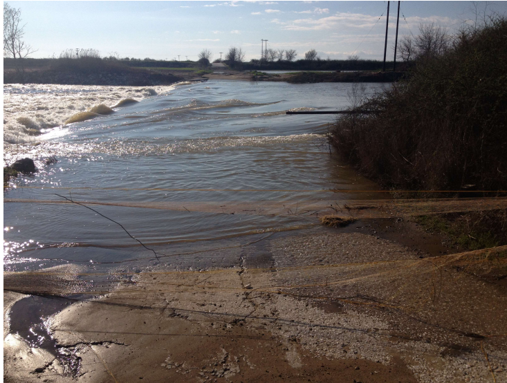
Σχήμα 7.46: Ποταμός Φιλιούρης (Λίσσος) στην Επαρχιακό Οδό Ιμέρου- Φαναρίου. Το ποτάμι έχει υπερχειλίσσει και το νερό έχει περάσει πάνω από τη γέφυρα. Πηγή: Αυτοψία Αναδόχου (30/03/2015).
