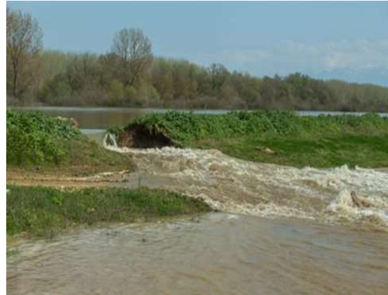
Σχήμα 7.46: Σπασμένο ανάχωμα στην περιοχή του Πεθελινού 29/03/2015.
