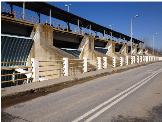
Σχήμα 7.43: Θυροφράγματα στο Φράγμα Λιθότου-Κερκίνης.
