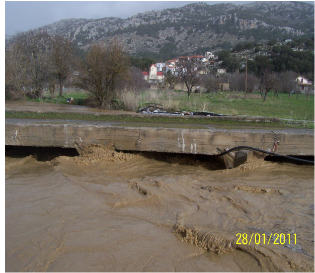
Εικόνα 4-9: Ανύψωση στάθμης νερού σε τεχνικό
