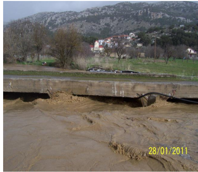
Φωτογραφία 7.4: : Ανύψωση στάθμης νερού σε τεχνικό
