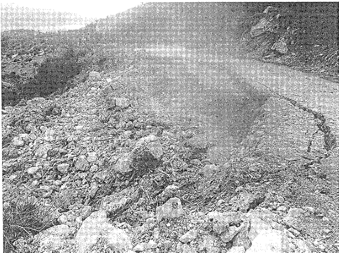
Φωτ. 16. Κατολίσθηση στην ευρύτερη περιοχή του οικισμού Ασπρογέρακας (υποέργο 13).
