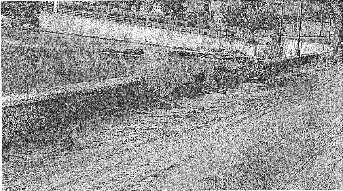
Φωτ. 11. Καταστροφές στην Αγία Ευφημία (υποέργο 9).
