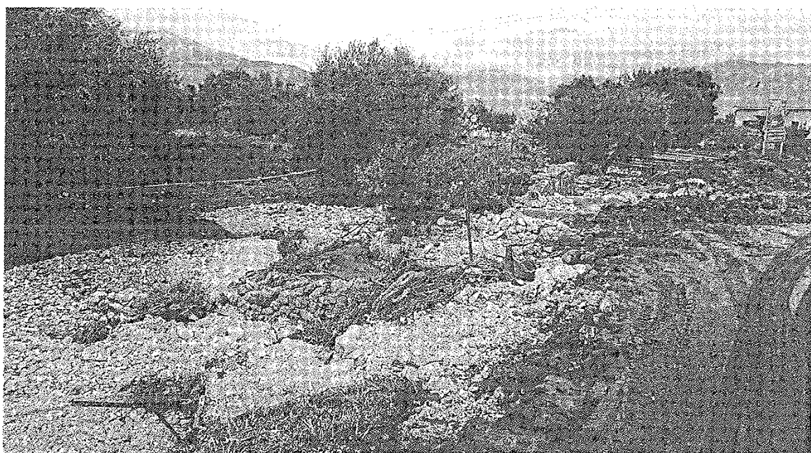
Φωτ. 6. Καταστροφές στο υδατόρεμα Πετάλη στην περιοχή Καραβόμυλου Σάμης (υποέργο 6).
