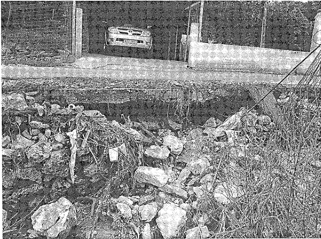
Φωτ. 7. Υποσκαφή επιχώματος κοντά στο ρέμα Πουλάτων Σάμης (υποέργο 7).
