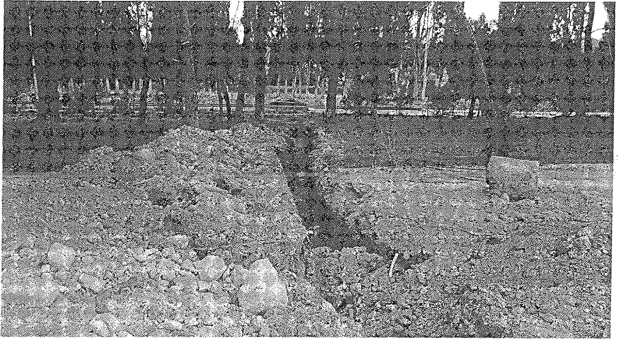
Φωτ. 1. Καταστροφές και πρόχειρα προσωρινά αποστραγγιστικά έργα στην έξοδο του Αργοστολίου προς Κοκκολάτα (υποέργο 1).
